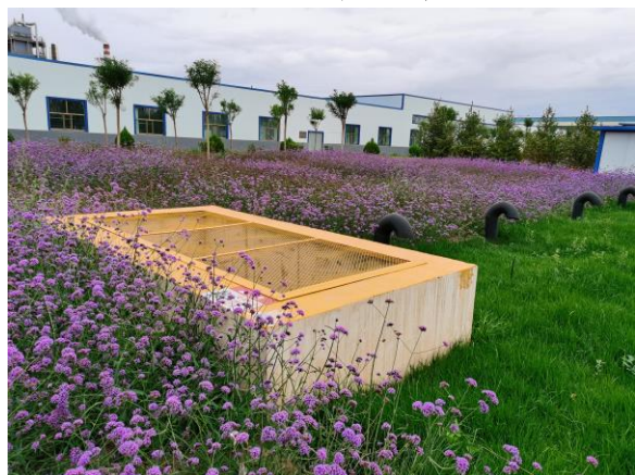
地下初期雨水池
