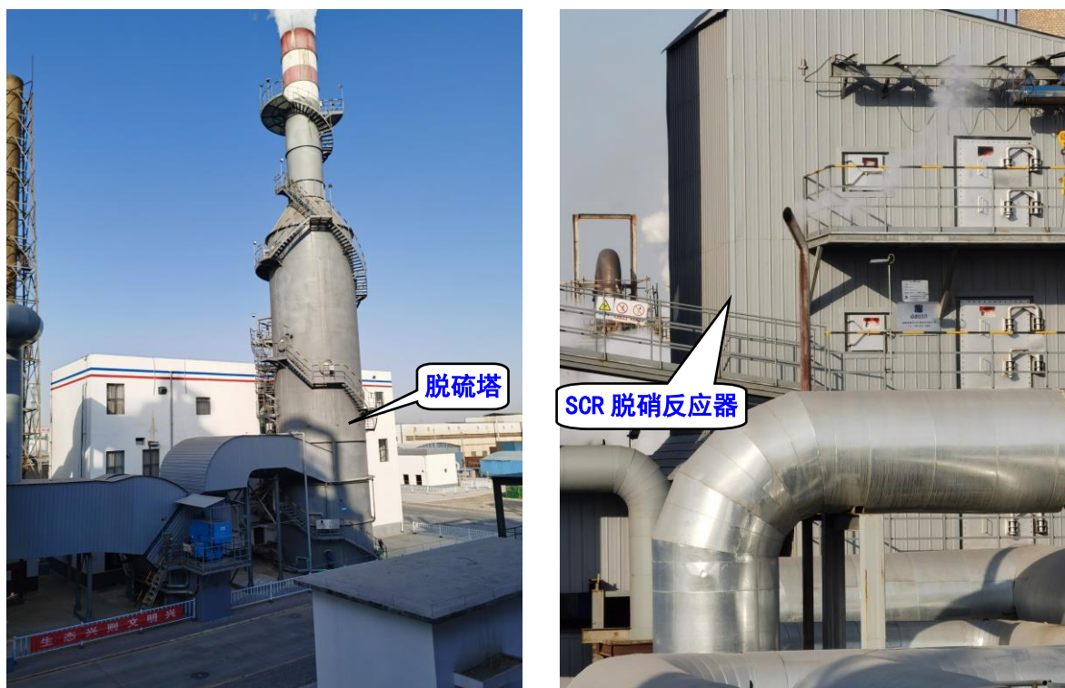
石灰-石膏脱硫装置
