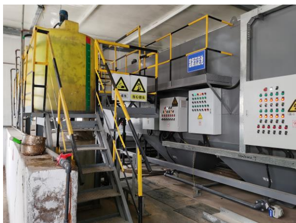
生产污水处理设施
