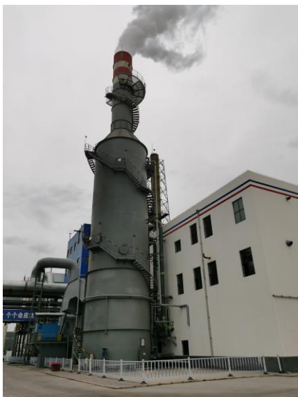
总废气排气筒
