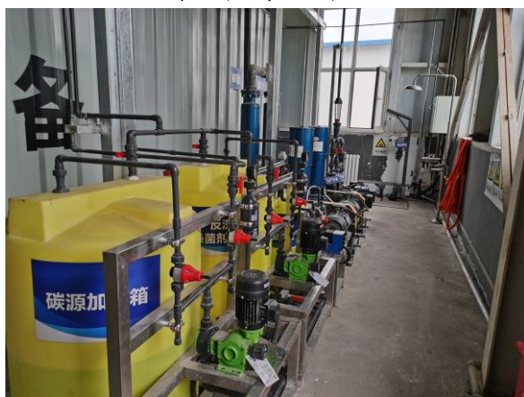
生活污水处理设施
