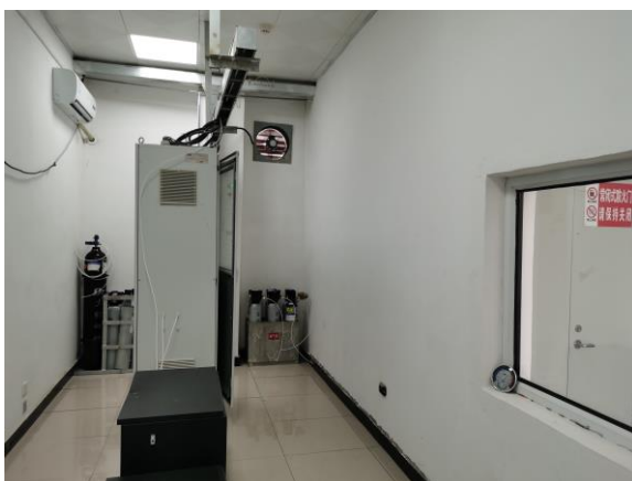
废气在线监测系统
